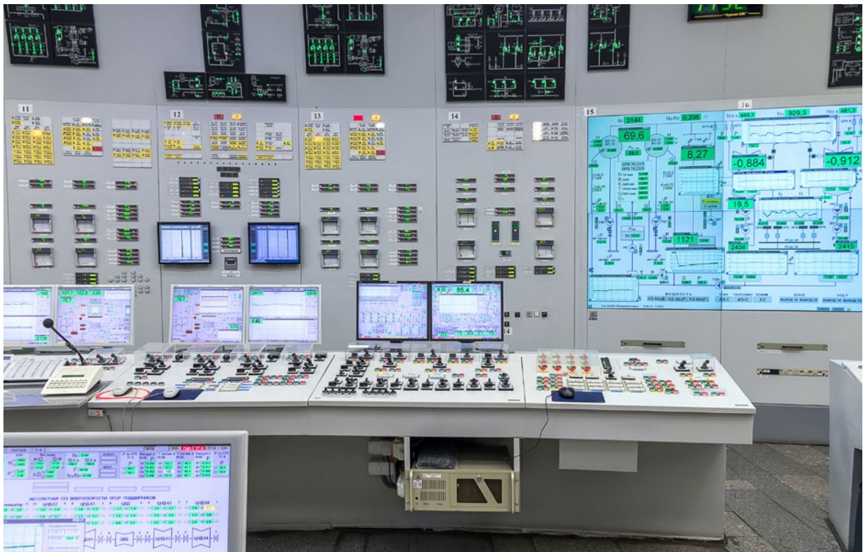
Kontrollraum in einem Kernkraftwerk
