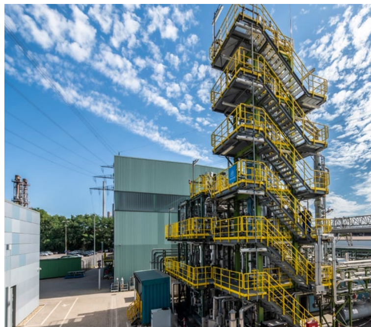
Das „Carbon2Chem“-Technikum am ThyssenKrupp-Standort in Duisburg
