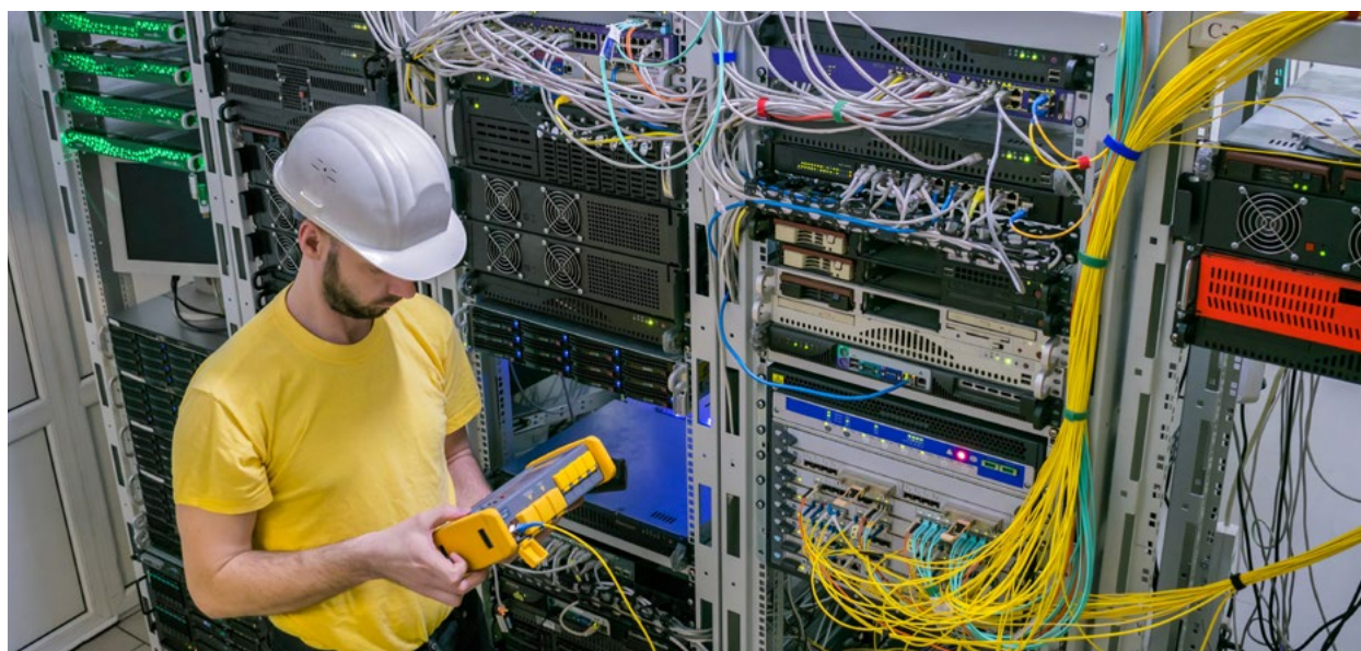
Ein Techniker nimmt Messungen im Serverraum eines Rechenzentrums vor.
